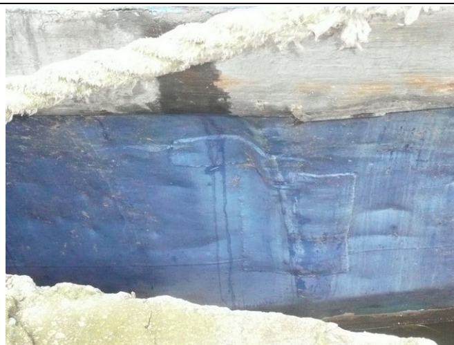
Фотография 3.8. Внешний вид Объекта оценки (правый борт, внешние дефекты корпуса)
